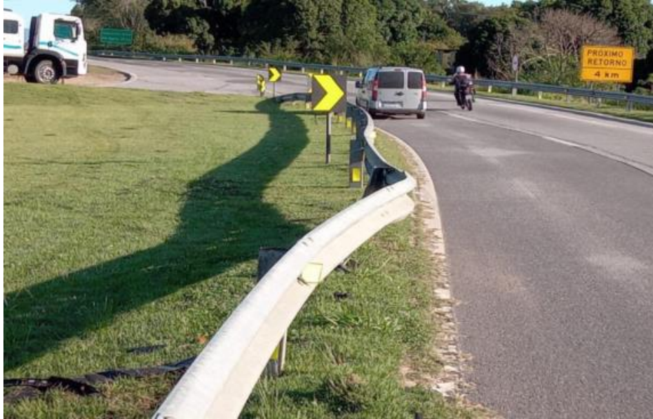
FOTO 03 – Dispositivo de Segurança - Km 29+100 Sul [1]
