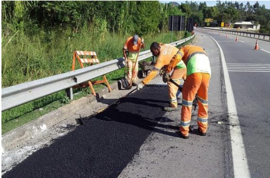
FOTO 01- Acostamento - Rep Superficial - Km 20+000 Norte
