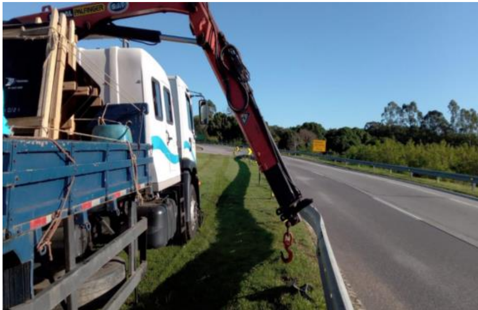
FOTO 04 – Dispositivo de Segurança - Km 29+100 Sul [2]
